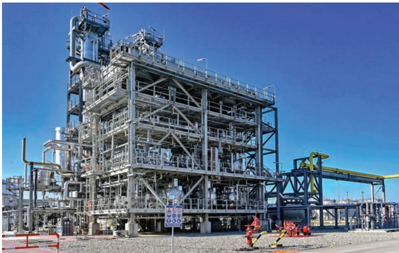
De upgrader bestaat uit roestvrijstalen tanks, die zijn verbonden door leidingen
